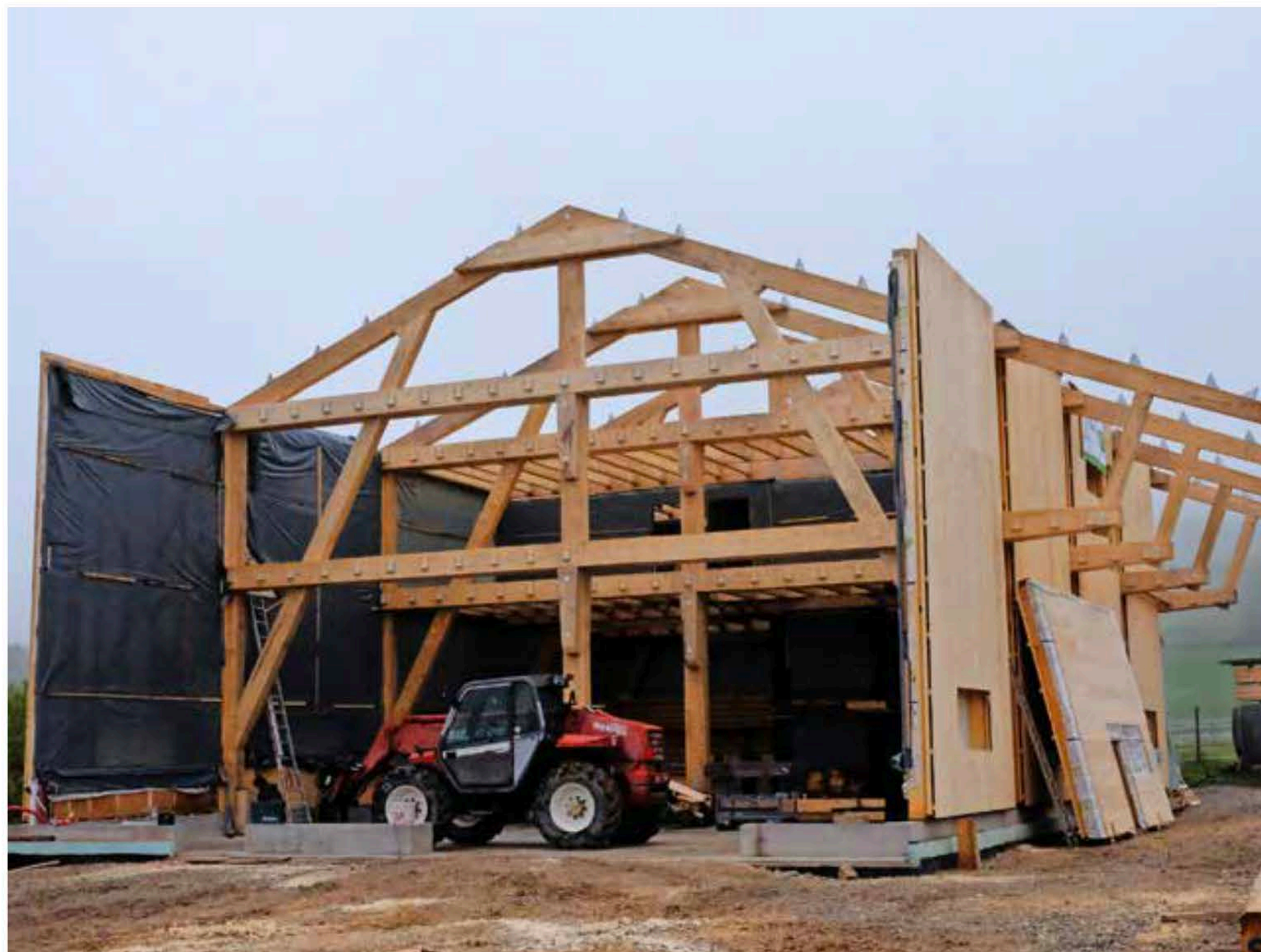
Imposantes Bauwerk mit regionalen Materialien: die neue Werkhalle der Firma Uehlinger in Siblingen.
